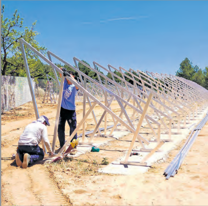
Las instalaciones tendrán una potencia de 100 kilowattios. R. L.
